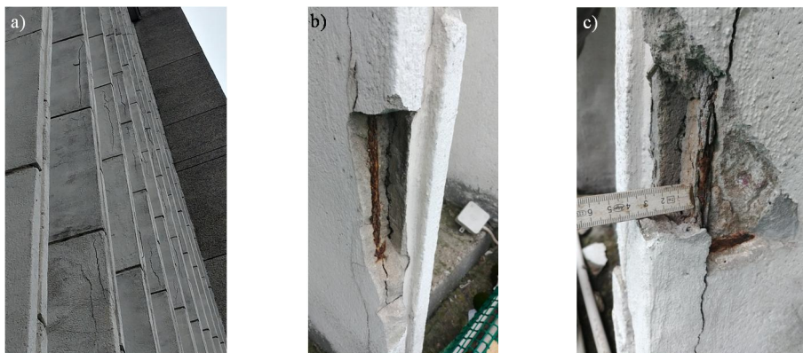
Rys. 5. a) – widok na rozległe uszkodzenia elementów elewacyjnych; b) – przykład wykruszeń elementu; c) – pomiar głębokości karbonatyzacji i otuliny [9].
