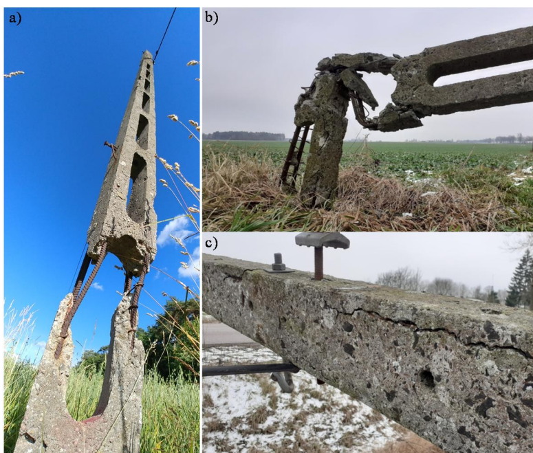
Rys. 6. a) – widok na uszkodzony słup; b) – rozległe odspojenia otuliny w elemencie; c) – destrukcja elementu.
